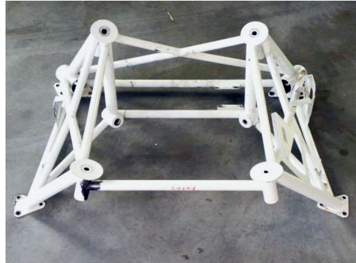
An diesem Rahmen für die Aufnahme eines Motors wurden Risse beobachtet.
