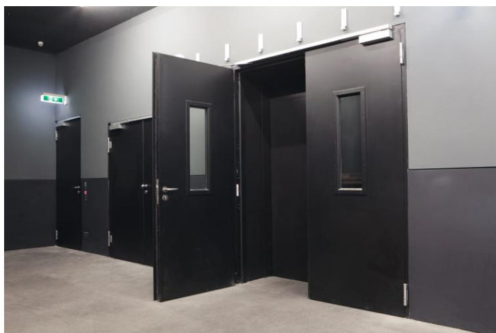
Anlieferungszone. Auch diese Funktionstüren sind im „Elbphilharmonie-Schwarzton“ ausgeführt – auch hier mit Blockzargen in Wandtiefe. Edelstahlbänder unterstreichen die Eleganz und tragen zur Langlebigkeit bei. Rauchmelder und Magnetfeststellanlagen sorgen für hohe Funktionalität im Alltag.
