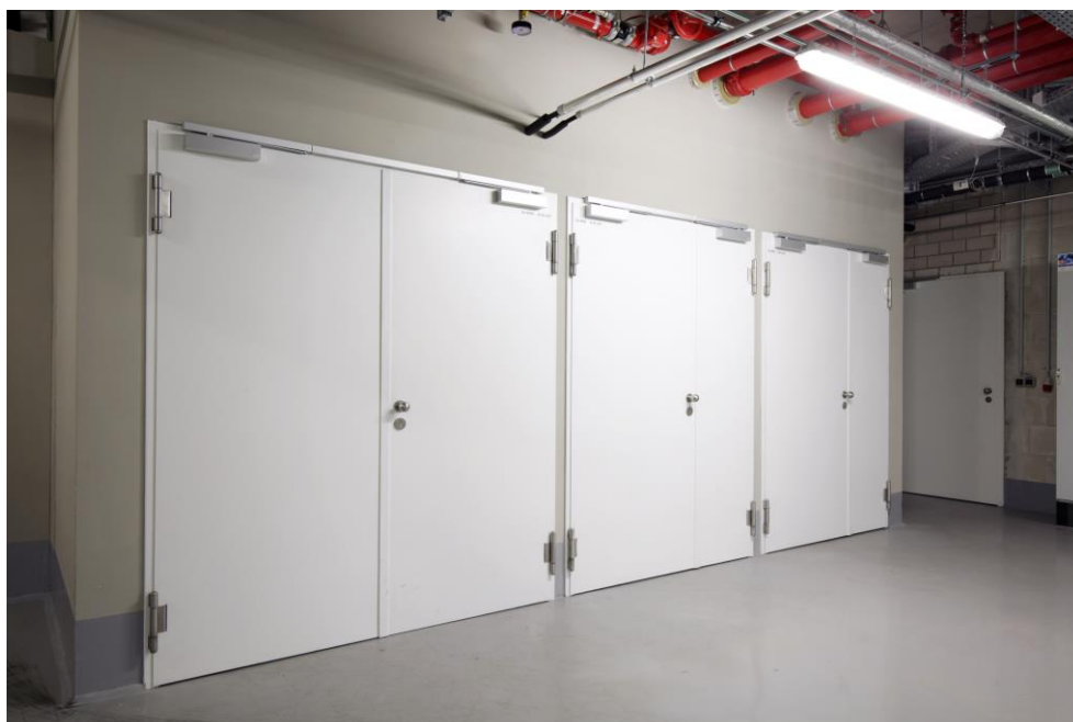
In der Technikzentrale der Elbphilharmonie sind verschiedene Funktionsbereiche jeweils speziell zu sichern und zugänglich zu machen. Bestimmte Elektro-Einheiten sind zum Beispiel mit Brandschutztüren inklusive elektro-mechanischer Offenhaltung ausgestattet.
