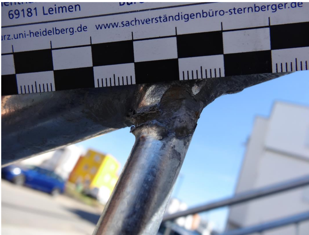
Offensichtliche Zinkabplatzungen als Zinkfehler.
