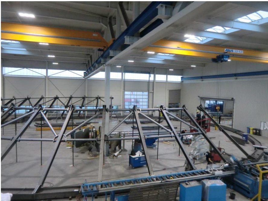
Anschließend wurde die Stahlkuppel wieder demontiert und auf der Baustelle in München wieder montiert.
