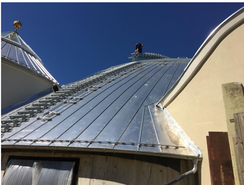
Die Eindeckung der Dachkonstruktion erfolgte mit einer Aluminium-Stehfalz-Konstruktion aus bombierten und sichelförmigen Blechen.
