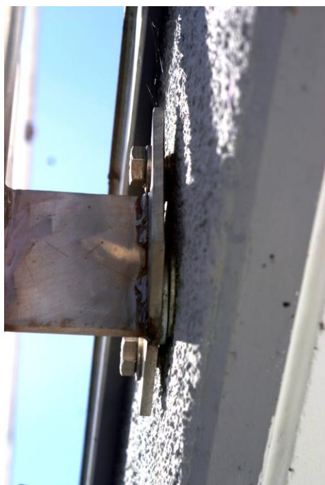
Der Spalt zwischen Ankerplatte und Montageuntergrund wurde teilweise mit Unterlegscheiben überbrückt - mangelhaft. Foto: Mink
