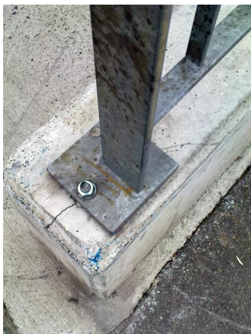
Der Randabstand ist zu gering. Schon beim Anziehen des Bolzenankers bricht die Betonecke. Der Sichtbeton muss aufwändig saniert, der Fußpunkt des Geländers versetzt und ein Injektionsanker eingesetzt werden. Foto: Braun
