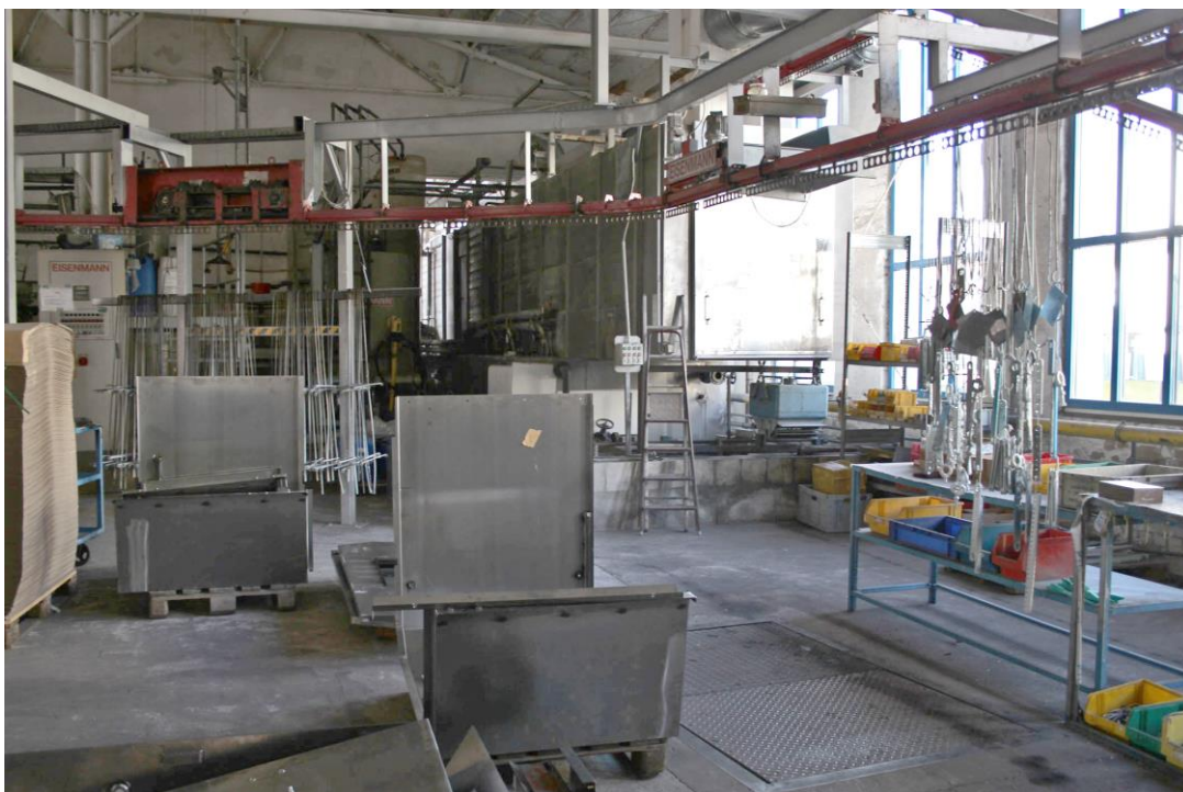
Reinigen, Strahlen und Vorbehandeln – mit moderner Fördertechnik durchlaufen die Teile die Reinigungsanlage.
