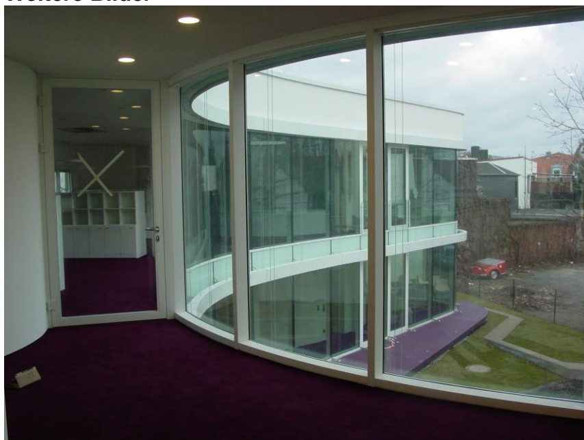
Absturzsichernde Verglasung bei der Medizintechnik Saegeling. Fotos: Anders
