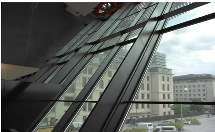
Geneigte Glasfassade (Innenansicht ZOB München). Foto: Montanstahl
