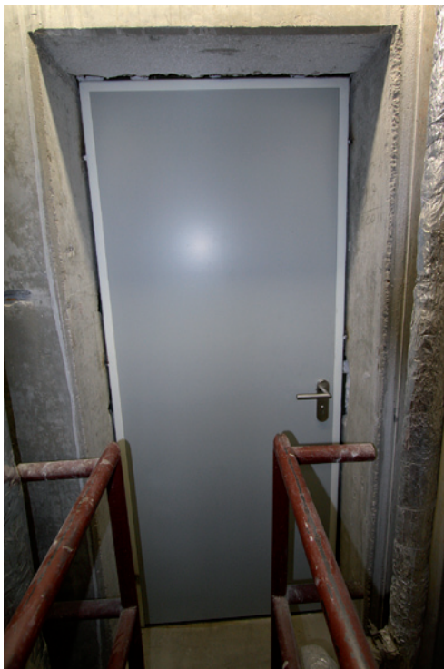
Abb. 2.63: Befestigung einer T 90-Tür in Eigenkonstruktion
