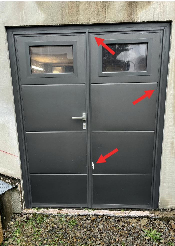
Falsch: Die Fehlstellen in der Lackierung waren teilweise schon von weitem zu erkennen.
