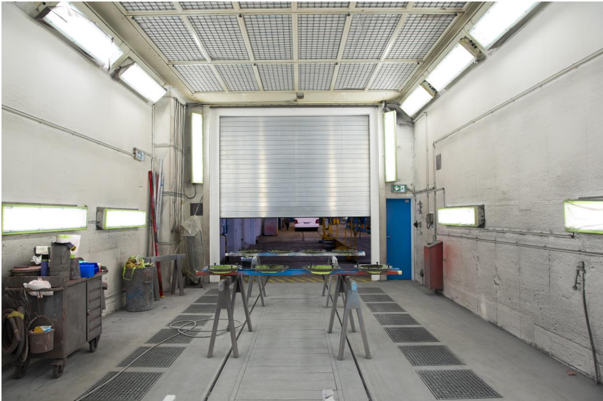
ATEX-EI2 30 C2 Sa-Tor in der Lackierhalle der BSAG: 3,65 mal 4,00 Meter groß, feuerhemmend, dicht- und selbstschließend, geeignet für die ATEX-Zonen 1 - IIA T4.
